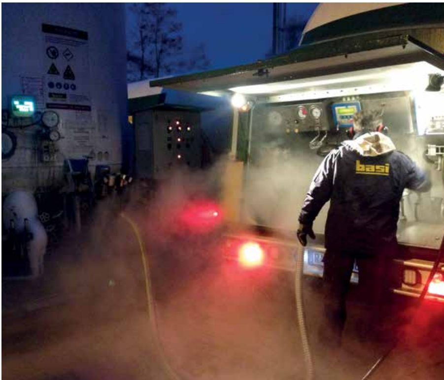
Befüllung eines Flüssiggastanks durch einen Tankwagen
